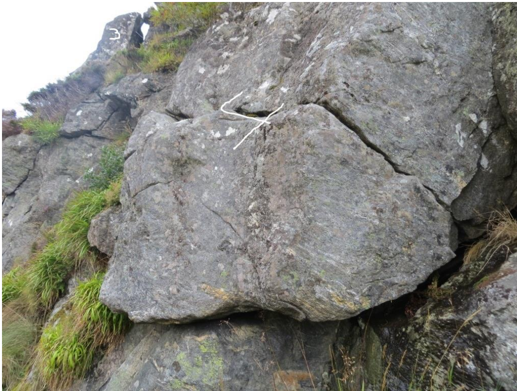
Figur 18: Blokker merket 3 og 4 på figur 15, sett mot nord. Potensielle utspringspunkter.
