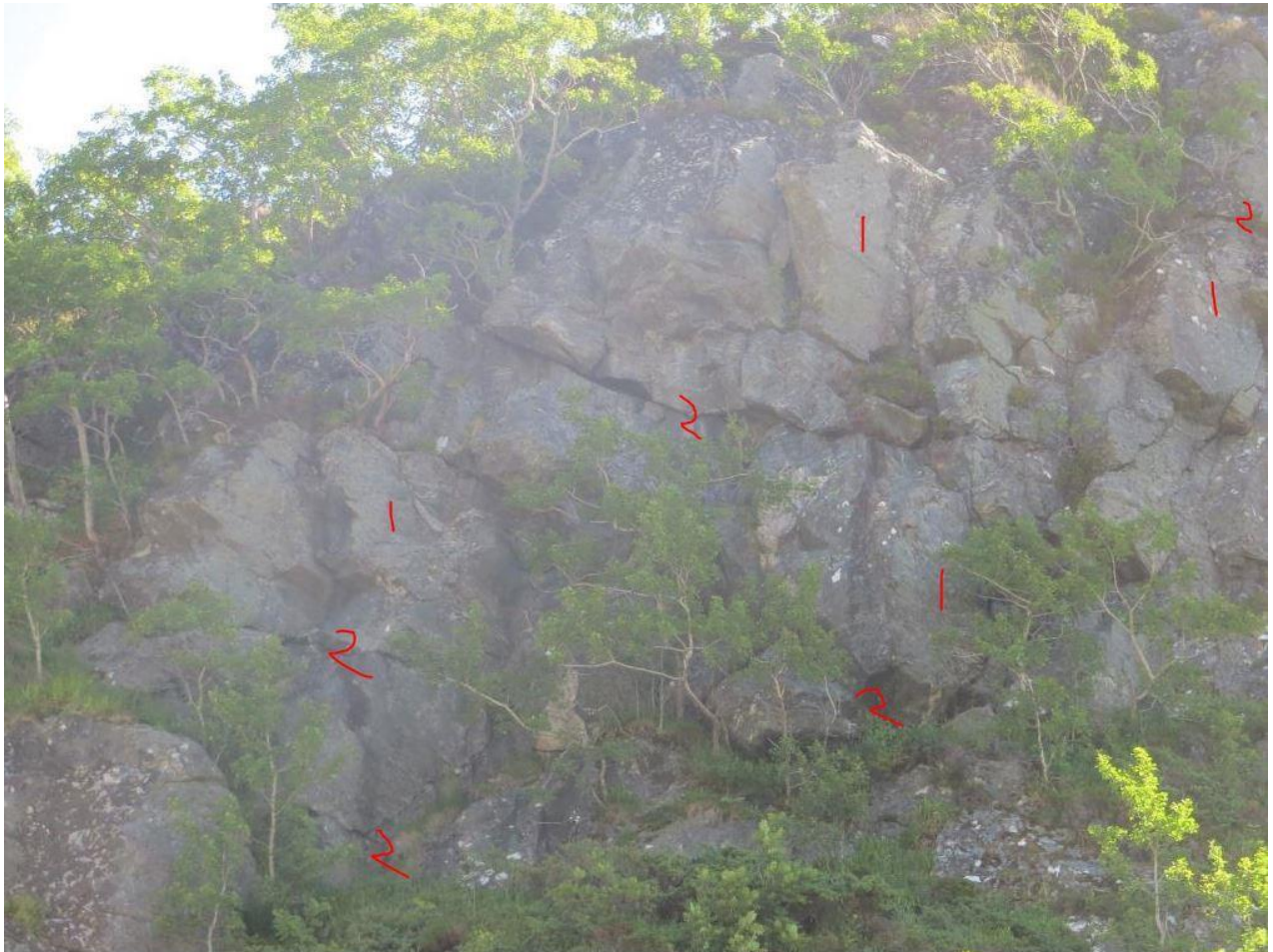
Figur 20: plan langs primært sprekkesystem 1 og sekundære sprekkesystem 2 i område C figur 7. Dette er fra område merket 5 og 6 i figur 15.
