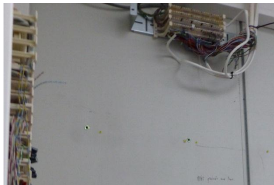
Figur 9: Installasjon som mangler beskyttelse
