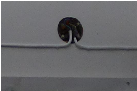
Figur 8: Viser at koblingsboks hvor deksel mangler
