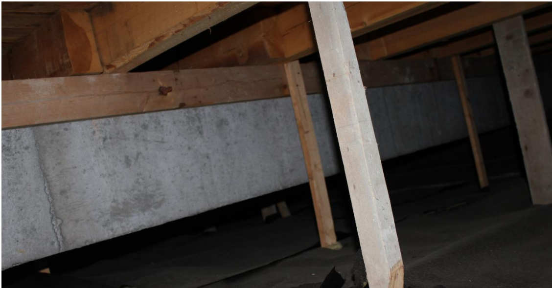
Figur 2: Bilde viser hulrom/kaldt loft i forbindelse med oppforet yttertak.
