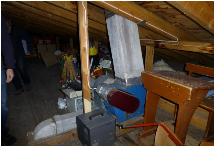
Figur 12: Bilde viser gammel avtrekksvifte på kaldt loft.
