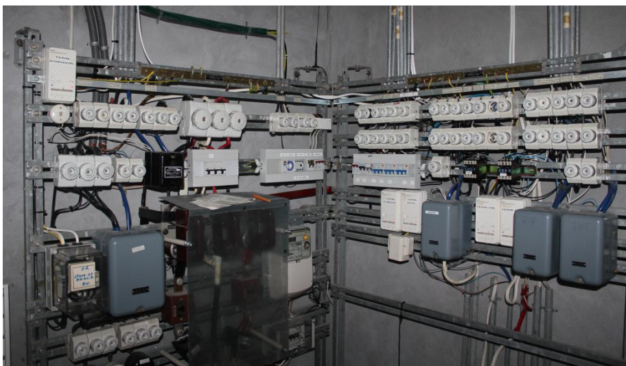
Figur 13: Bilde viser tavlerom i kjeller.
