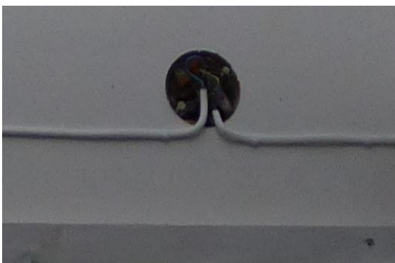
Figur 8: Viser at koblingsboks hvor deksel mangler
