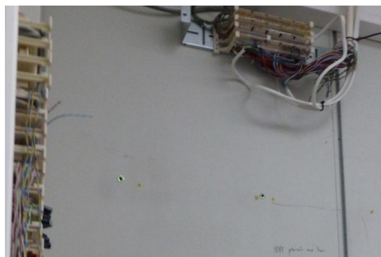
Figur 9: Installasjon som mangler beskyttelse
