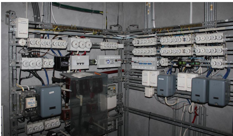
Figur 13: Bilde viser tavlerom i kjeller.
