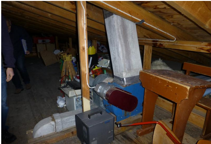
Figur 12: Bilde viser gammel avtrekksvifte på kaldt loft.
