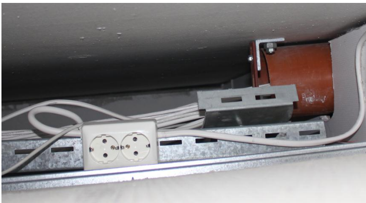
Figur 7: Viser kabelbro over himling i forbindelsegang, samt mangelfull branntetting
