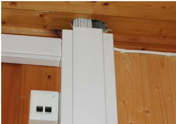
Figur 14: Bilde viser kabler i kabellist i korridor (rom 106) i 1. etasje.
