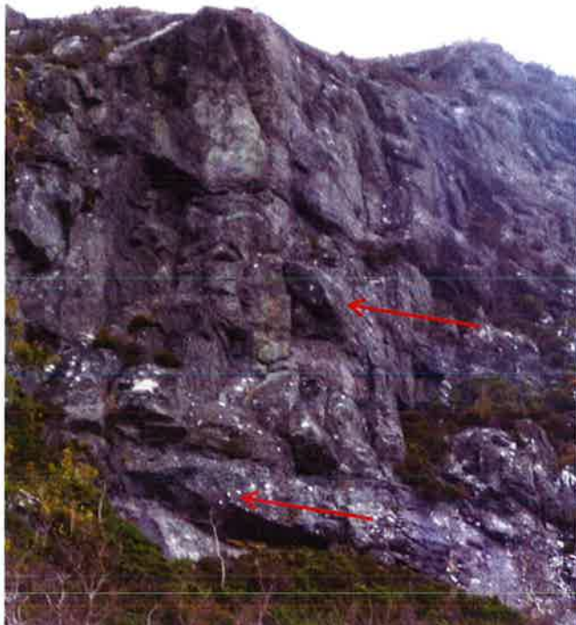
Figur 11: Bildet viser parti 7. Røde piler markerer blokker som kan være aktuelle å boltesikre.
