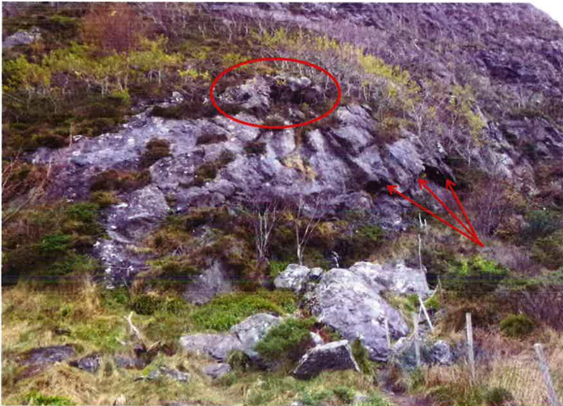
Figur 13: Bildet viser parti 9. Røde piler viser blokker som bør boltesikres. Innenfor rød sirkel bør vegetasjon renskes og blokker renkes eller boltes fast.
