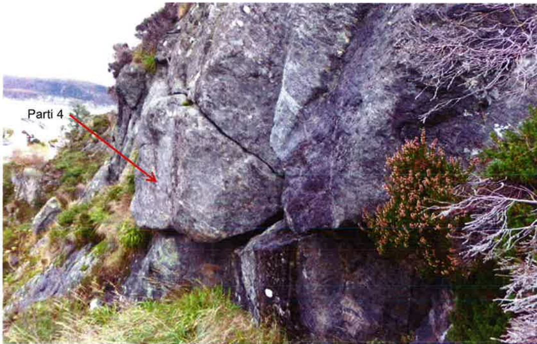
Figur 8: Parti 4 mangler tilstrekkelig fot. Boltesikring av nedre del vil sikre partiet over.
