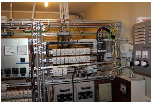
Bilde 21 viser deler av hovedtavle i teknisk rom.
