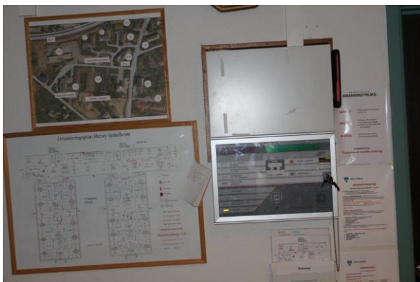
Bilde 29 viser brannalarmsentral i vestibyle.
