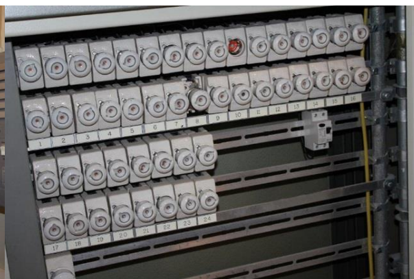
Bilde 22 viser sikringer i tavleskap som står mellom vestibyle for Grøn avdeling og matsal.
