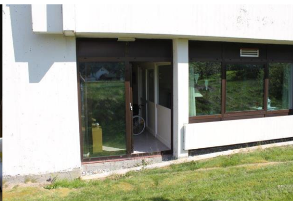
Bilde 36 viser samme dør som i bilde 34 fra utsiden. Legg merke til avstand til terreng og plen.
