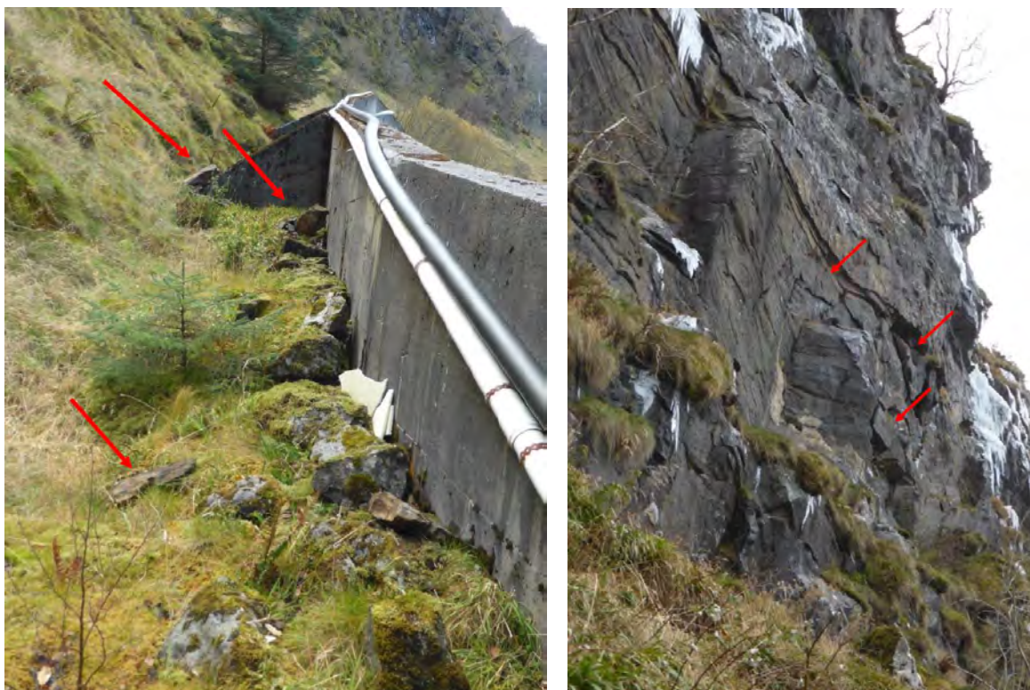
Figur 4-7 Betongmuren med gamle og nye (pil) steinsprangblokker. Fleire blokker på veg frå skrentane..
