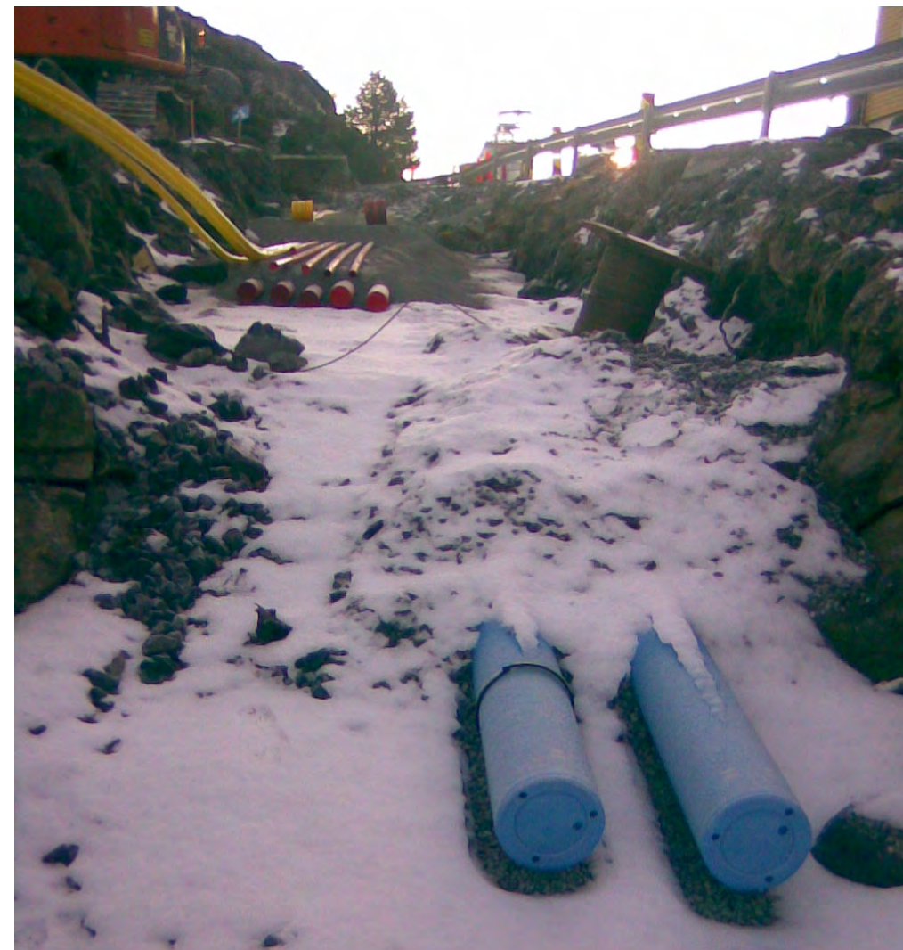
Figur 6: På bildet ses hovedvannledningen og kabler fra både Telenor, TussaNett og MøreNett. Bildet er tatt ved samfunnshuset i retning mot kirka.
