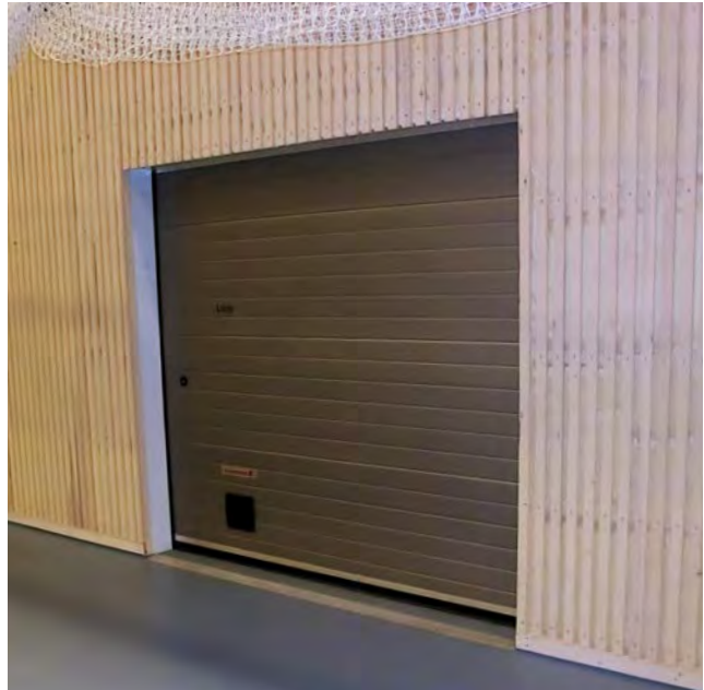
Port til lagerrom. Foto: Morten Roa
