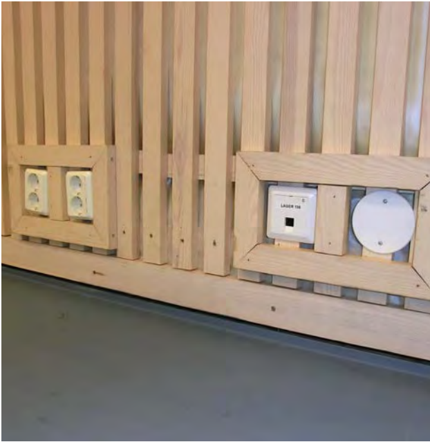
Beskyttelse av elektriske installasjoner Foto: Morten Roa
