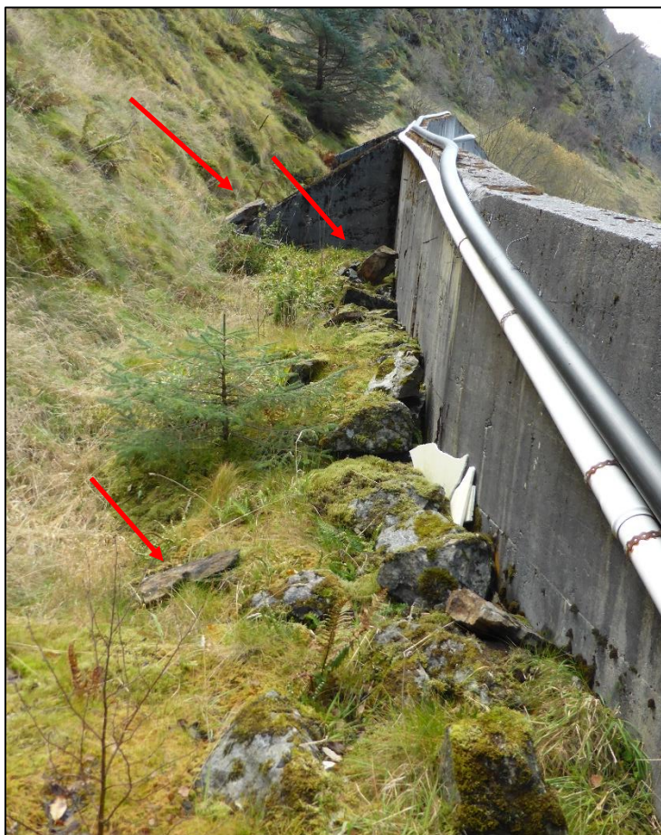
Figur 3-11 Ferske steinsprangblokker bak betongmur. Her er muren ca. 2 meter høg. De steinsprangblokkane som er med minst vegetasjon på seg, og dermed blitt vurdert til å vere yngst, er merka med raud pil. Bildet er tatt vestover frå GPS punkt 698.
