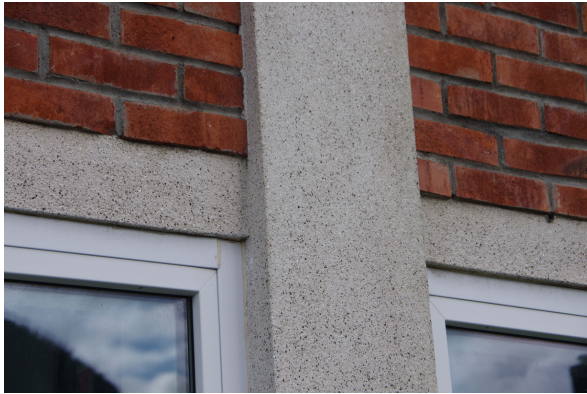
Bilde 1 eksponert betongdekke/betongsøyle
