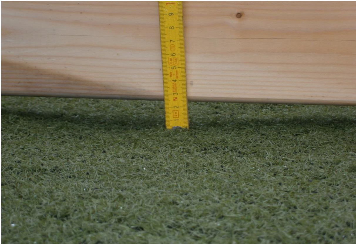
Det ble målt flere svanker på +/- 30 mm
