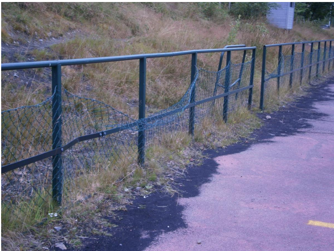
Gjerde bør repareres når kunstgresset blir rehabilitert
